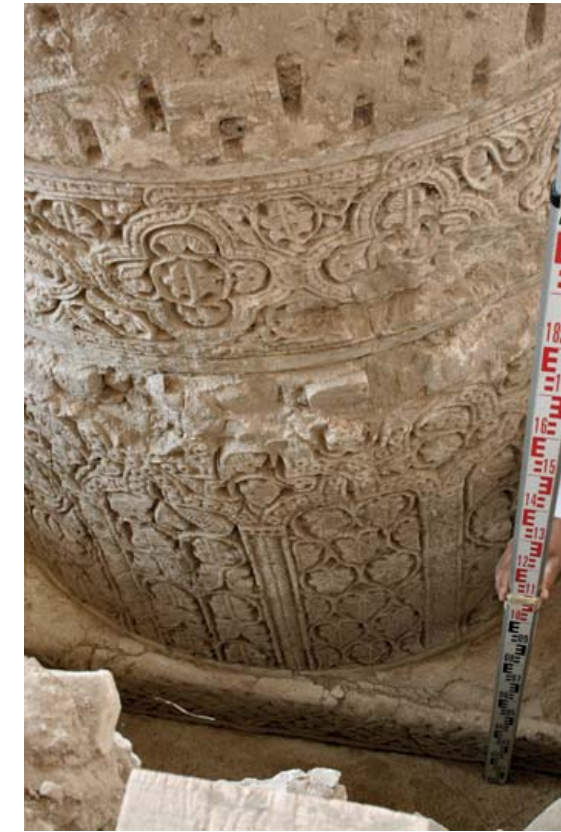
FIG. 14. – Mosquée Hâji-Piyâdah/Noh-Gonbadân. Face ouest de la partie inférieure de la colonne 11 dégagée des débris qui l'entouraient et dont une partie est visible en bas de l'image (© Adle).
